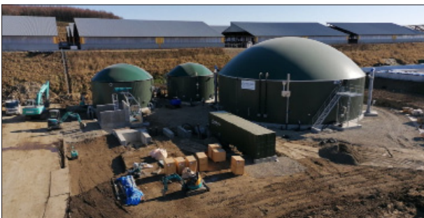
La centrale au biogaz de 250 kilowatts située à Urahoro, à Hokkaido, entrera en service à l'été 2021.
