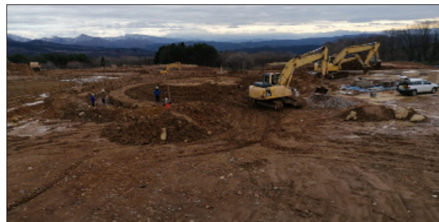
À Sakata, sur l'île principale de Honshu, des étables sont actuellement construites en plus de l'usine de biogaz. Ce site devrait être prêt à l'automne 2021.
