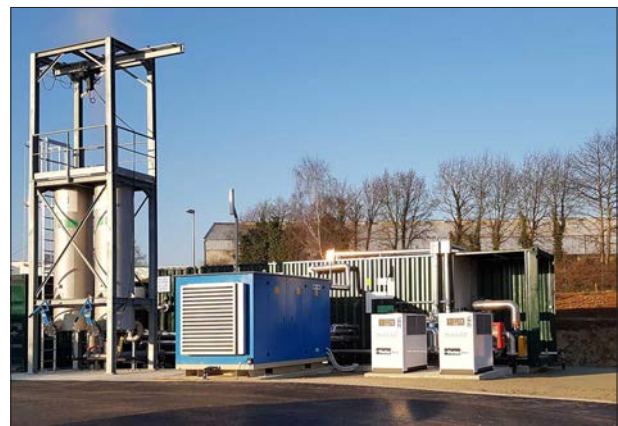
WELTEC BIOPOWER a intégré une solution compacte en conteneur avec la technologie membranaire pour le conditionnement du biogaz.
