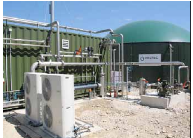
Le 5 août, l'installation de biométhanisation « Longchamps » en Franche-Comté a été mise en service. Depuis, 70 normaux mètres cube par heure de biométhane sont injectés dans le réseau de gaz naturel GrDF (Gaz réseau Distribution France).
