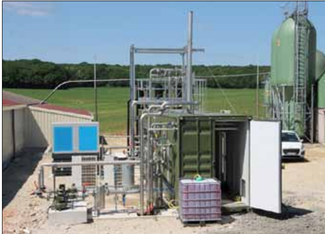
Le constructeur d'installations WELTEC BIOPOWER a opté pour une technique membranaire flexible et compacte pour une épuration efficace du biogaz.
