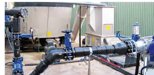
Positionnement du MULTIMix entre le système d'incorporation de matières solides et le digesteur.
