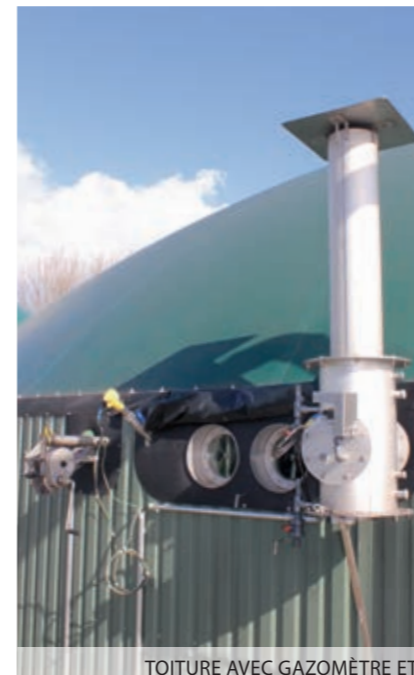
TOITURE AVEC GAZOMÈTRE ET UNITÉS DE CONTRÔLE
