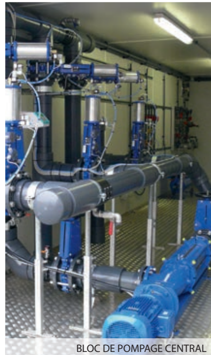
BLOC DE POMPAGE CENTRAL
