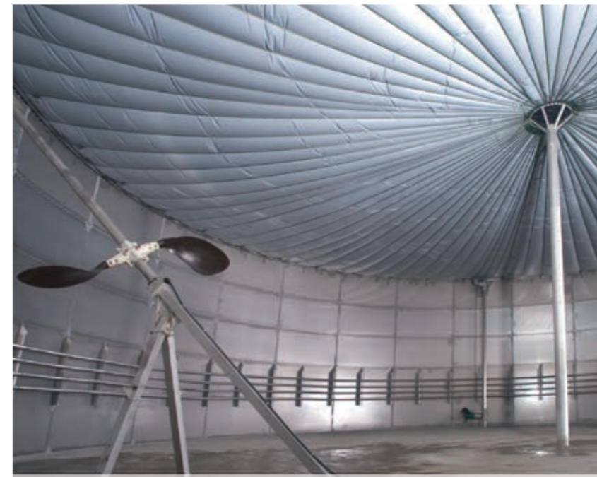
DIGESTEUR AVEC AGITATEUR AXIAL, VUE INTÉRIEURE
