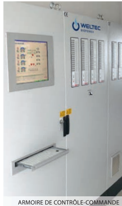
ARMOIRE DE CONTRÔLE-COMMANDE
