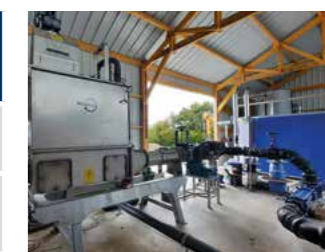
Positionnement du MULTIMix entre la trémie d'alimentation des solides et le digesteur.
