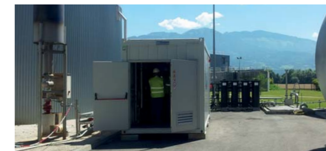
L'installation en Rhône-Alpes présente la solution compacte en conteneur.
