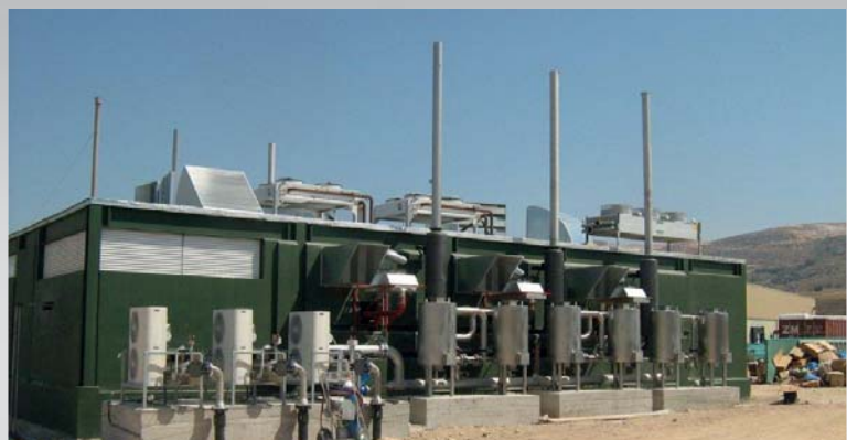
7 cogénérateurs avec une capacité d'1,8MW produisent l'électricité et la chaleur.
